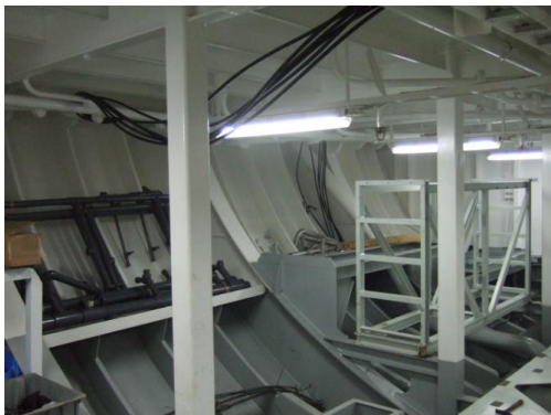
RO Gestell, links vorgefertigte Rohrleitung
